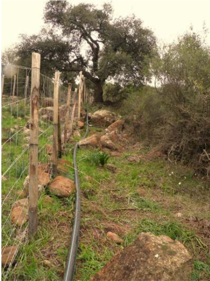
Fig. 5. Condotta principale dell'impianto di irrigazione
