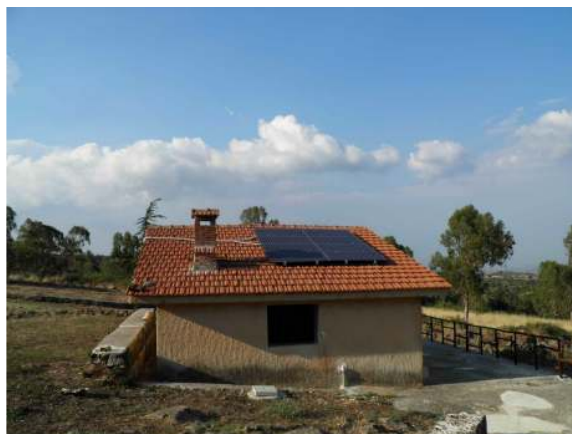
Fig. 4. Pannelli fotovoltaici a servizio delle strutture di acclimatazione a Bosco Pisano
